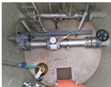
Elektryczny regulator przepływu - eksploatacja w warunkach suchych
