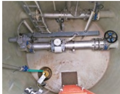
Contrôle de débit électrique, temps sec
