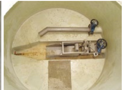
Contrôle de débit mécanique, faibles débits pluviaux
