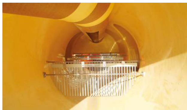
Barras em PRFV flexíveis e autolimpantes retêm os sedimentos na câmara CSO da Amiblu. A água limpa sai da câmara através de um transbordo.
