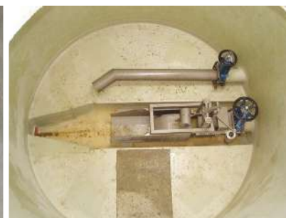
Medidor de vazão mecânico, funcionamento a semi-seco
