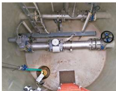
Medidor de vazão elétrico, funcionamento a seco
