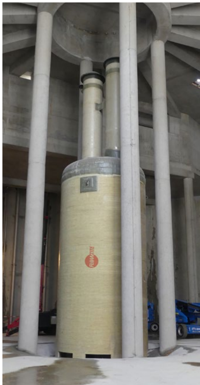
Powyżej: Pionowa rura Flowtite DN 3000 o długości 7 metrów stanowi część systemu spłukiwania wewnątrz zbiornika retencyjnego
