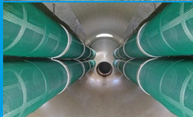
Powyżej: Kanał retencyjny ze zintegrowanym systemem Amiscreen - widok z zewnątrz.
