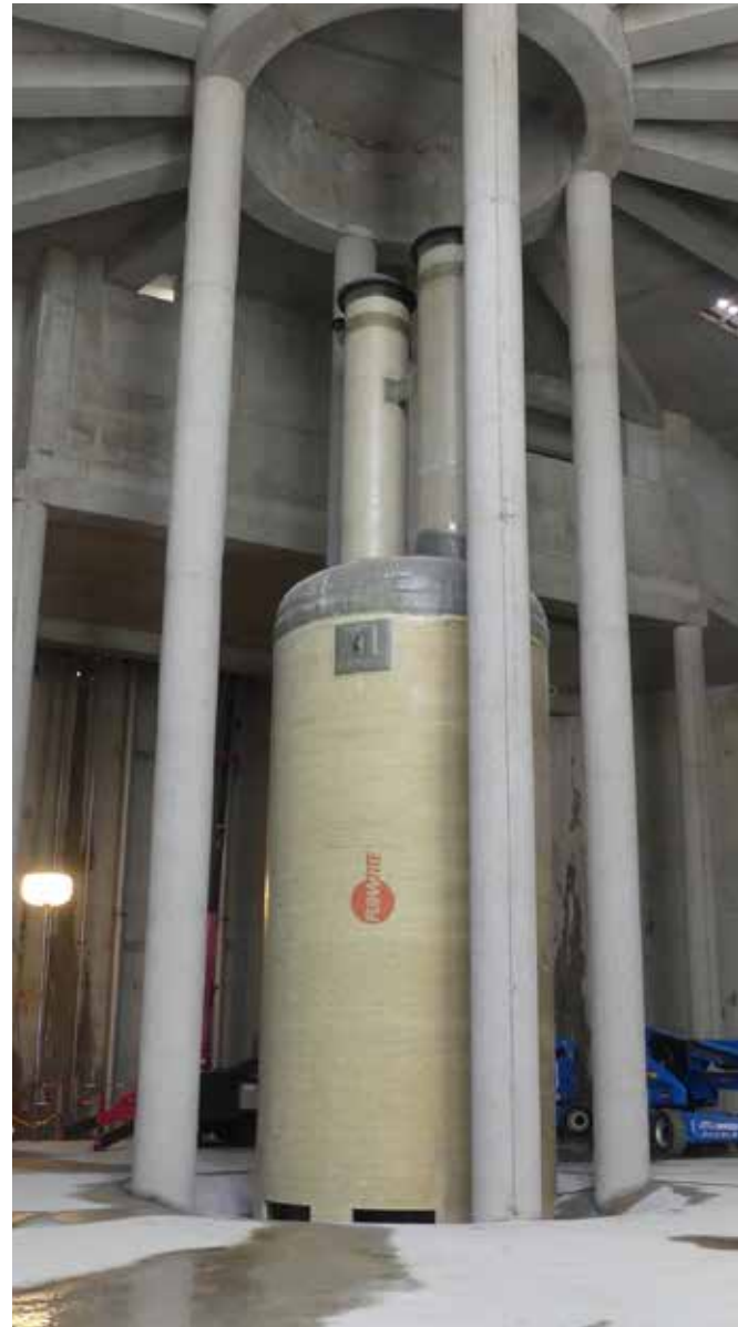
Oben: Ein 7 m langes vertikales Flowtite Rohr DN 3000 dient als Spülsystem im Inneren der Lagerkammer.
