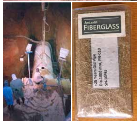
Abb. 9-11: Ein Flowtite GFK-Kanalrohr DN 1800 wurde nach fast 25 Jahren im Einsatz in einer Kläranlage in Riad, SA, freigelegt und geprüft. Das Rohr zeigte keine Anzeichen einer Verschlechterung.
