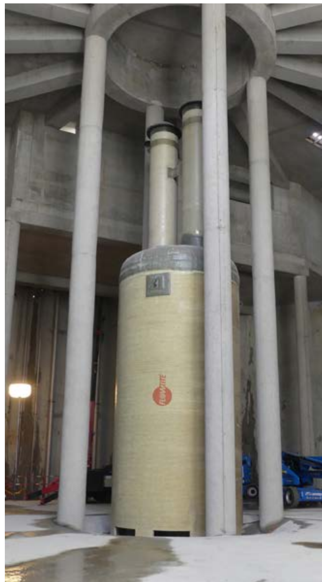
Ci-dessus: tuyau vertical DN 3000 de 7 m de long sert de réservoir de chasse à l'intérieur du bassin de stockage-restitution
