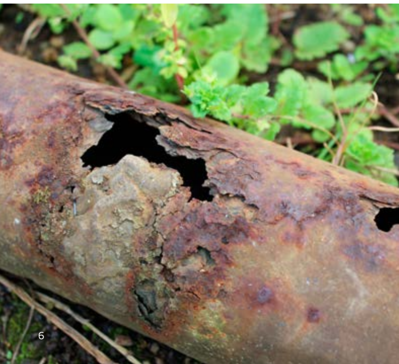
Fig. 1: Les conduites en béton ou métal se corrodent dans des environnements à faible pH sous l'influence d'acide sulfurique.
