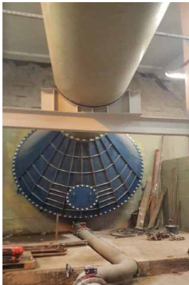
Fot. Widok na rurociąg zasilający DN 1000 i spustowy DN 250
