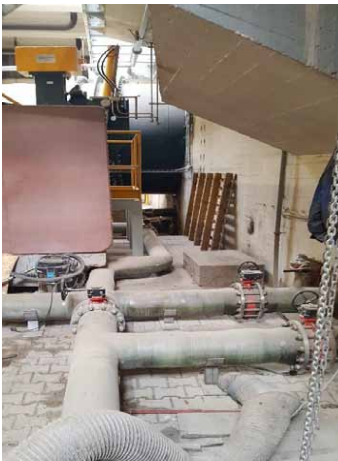
Fot. Rurociągi spustowe DN 250
