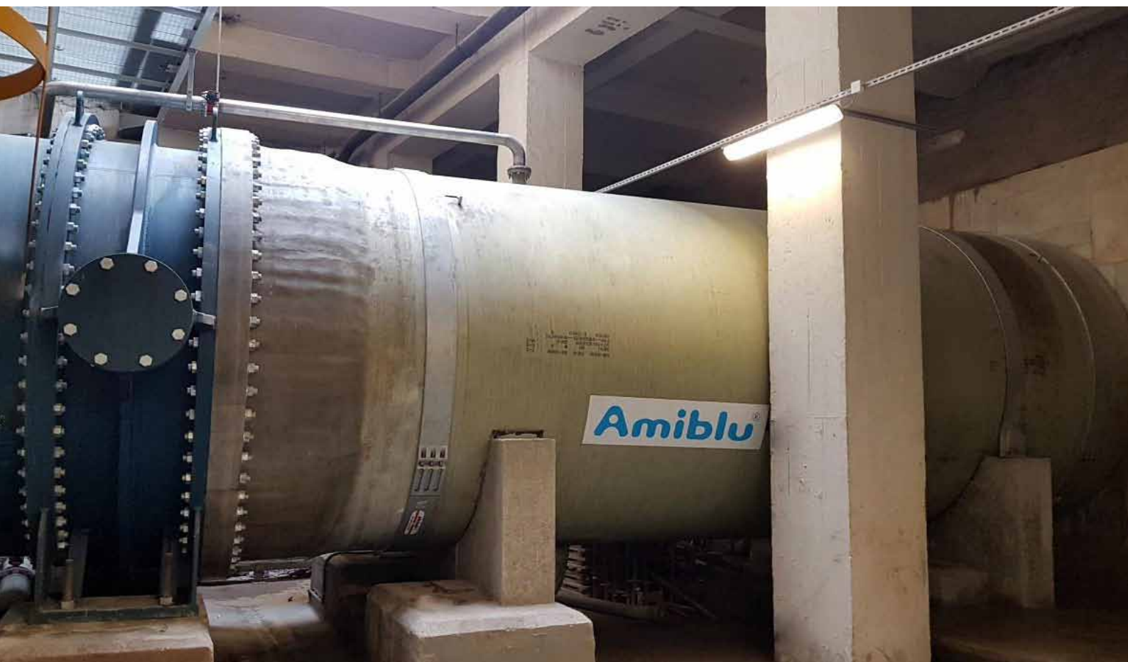
Fot. Gotowy rurociąg GRP z armaturą na hydrozespolu nr 3
